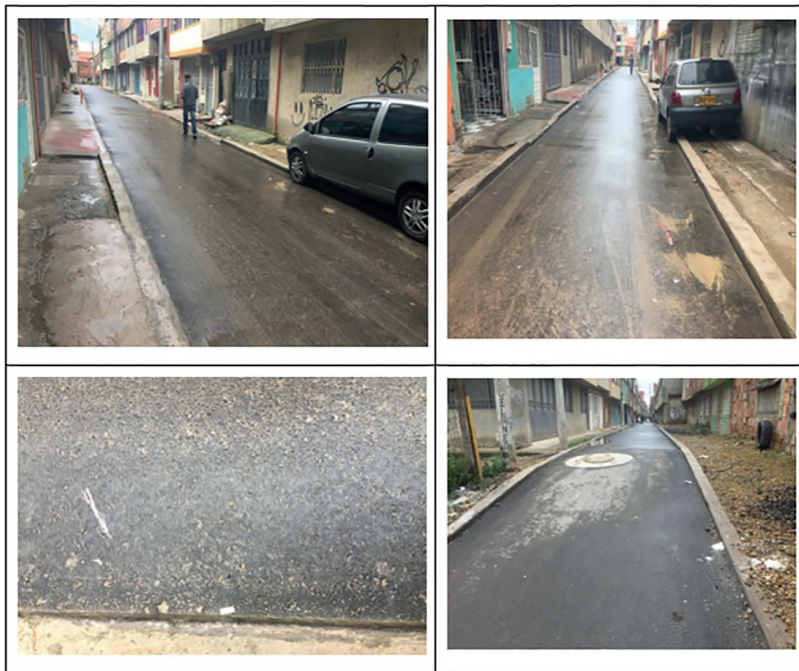
Figura 4. Estado de las vías intervenida con RAP, Suba-Lisboa calle 134 # 151A
